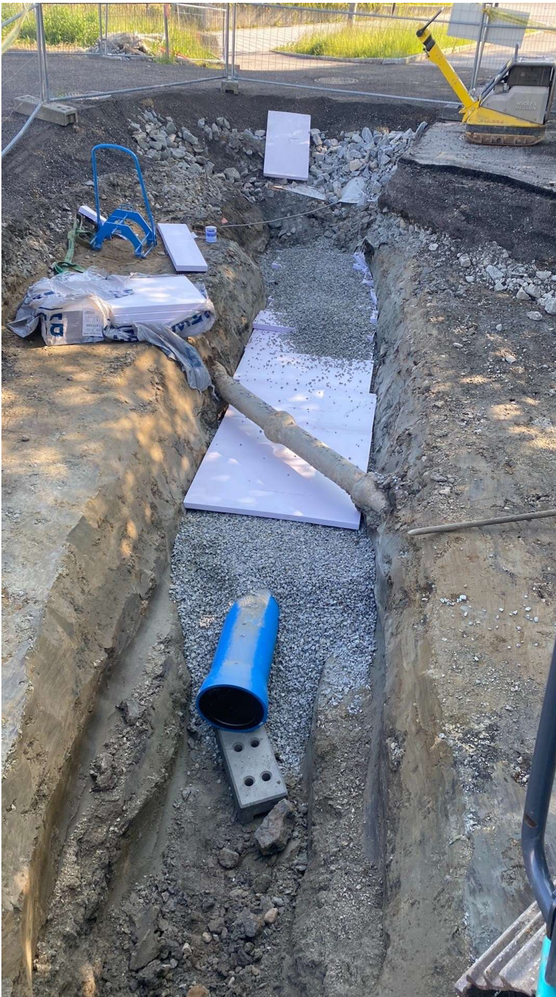
Figur 11: Isolasjon over ledning.
