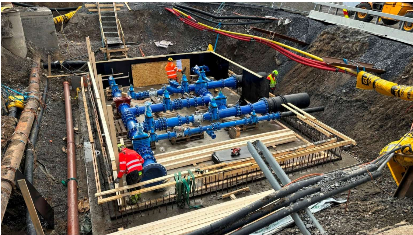
Figur 1: Oversiktsbilde av stopt fundament i en kompleks kum.
