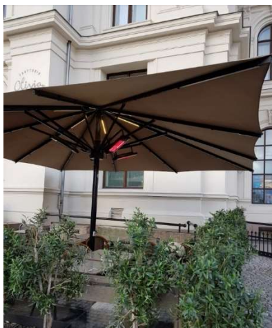
Varmeelement og belysning montert på parasoll. III: Trondheim kommune.
