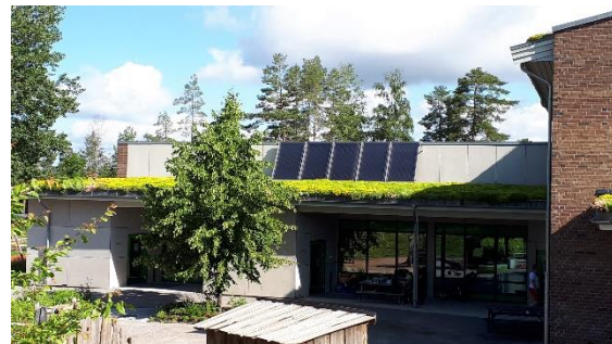
Figur 14. Solfangere på taket til Hareveien barnehage på Tårnåsen.
